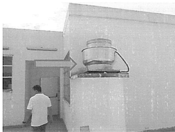
Equipo de extracción de aire en terraza no funciona
