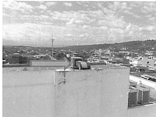
Equipo de suministro de aire no funciona
